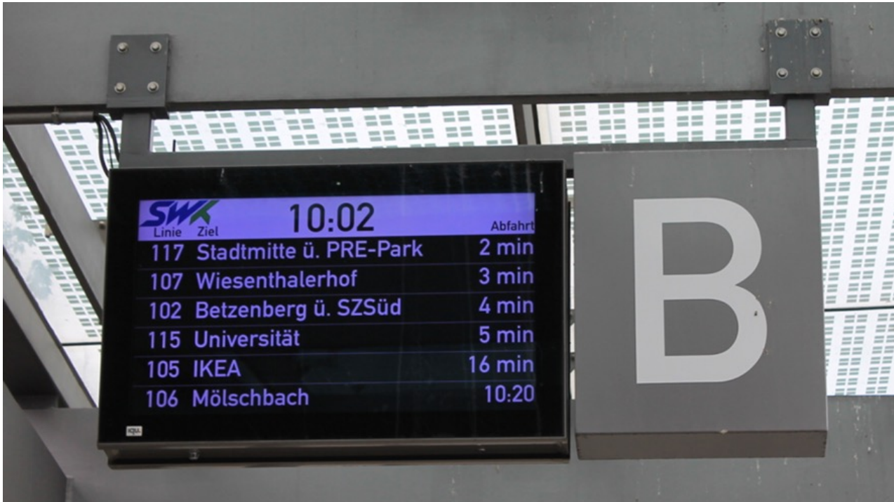
Abbildung 11: Echtzeit-Abfahrtsanzeiger des dynamischen Fahrgastinformationssystems
