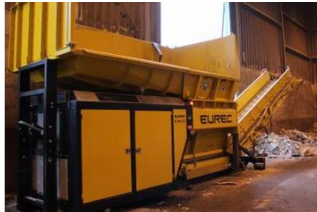
Abbildung: Zerkleinerer für Sperrabfälle in der Umschlagshalle
