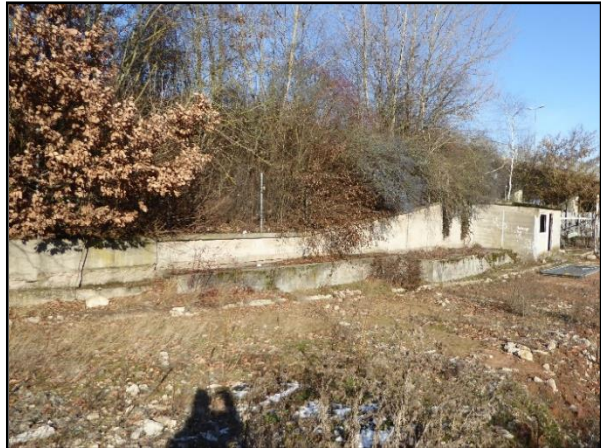
Abb. 9: Betonwand mit Rissen und kleines Gebäude (Blickrichtung Nordosten, eigenes Foto)
