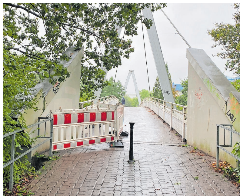
Ein Pilzbefall ist der Grund für die Absperrung auf der Brücke FOTO: PS
