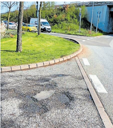
Die Schadstellen am Opelkreisel
