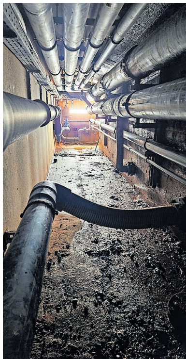
Das Schwimmerbecken ist mit einem Gang, durch den sämtliche Rohre laufen, mit den Technikräumen verbunden
